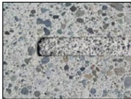
(d) Backfill material debonding
